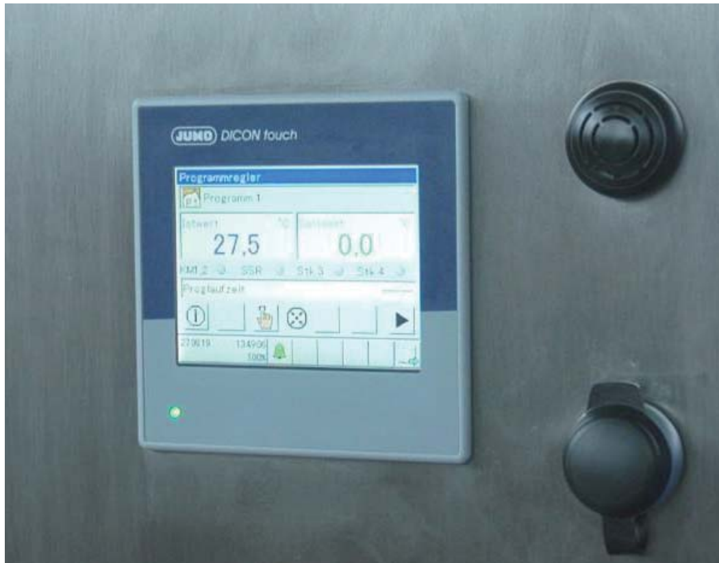
Πίνακας κατασκευής - επίπεδο χειριστή
